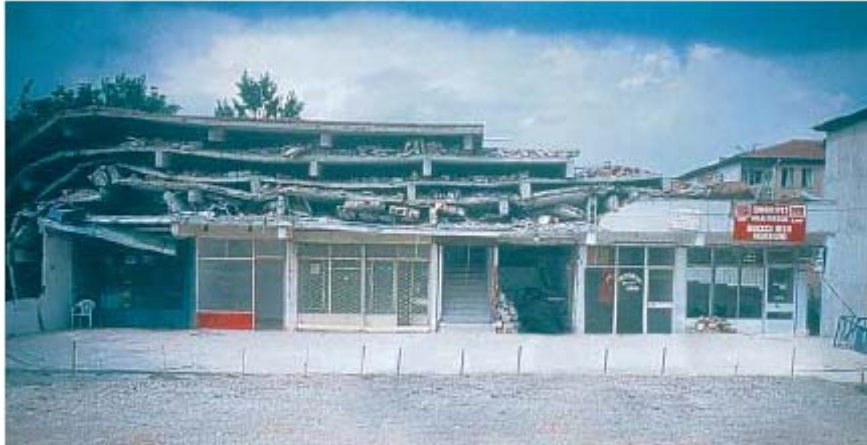
Figure 20 : Bâtiment avec un étage flexible à Izmut en Turquie, après le tremblement de terre de 1999 30
