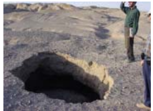
Effondrement du réseau d'irrigation traditionnel.
