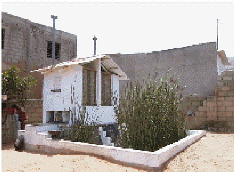
Modèle pilote de WC à sec / block toilette, avec double fosse et lits filtrants pour les eaux ménagères, les urines et les eaux de toilette – sert de façon courante à 21 personnes
